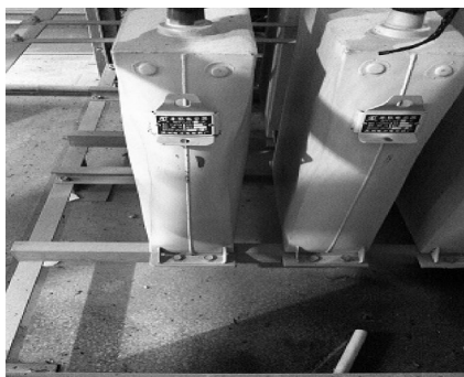
图2 部分电容器鼓肚现象 Fig. 2 Bulging phenomenon of some capacitors
